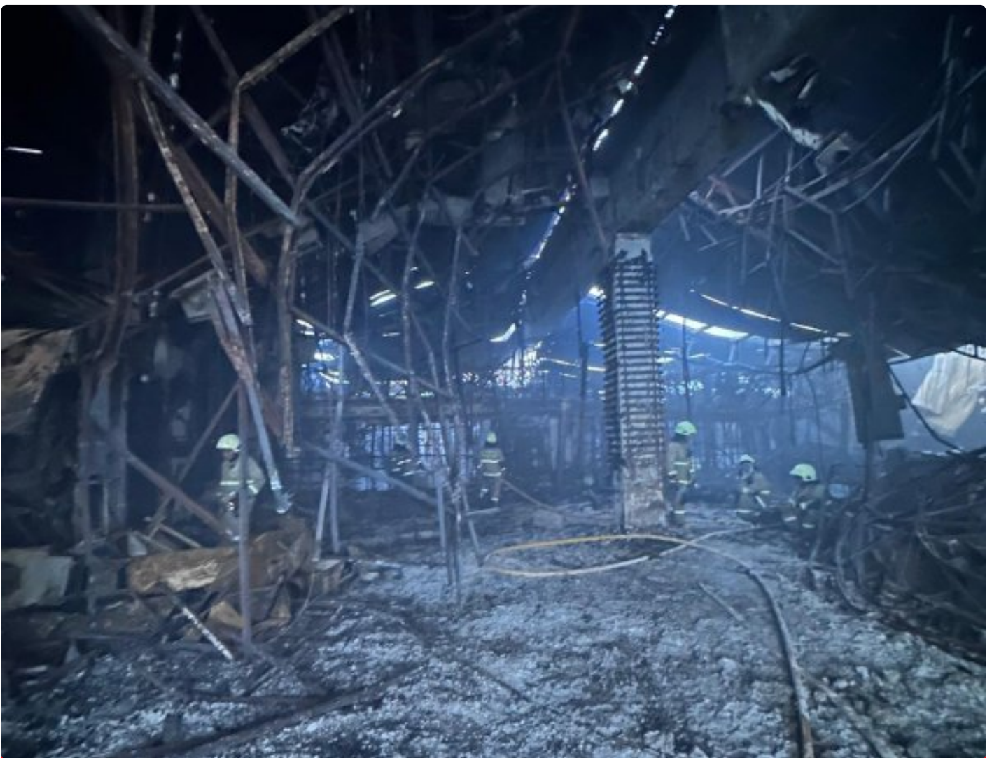
Glodok Plaza yang Hangus Terbakar
